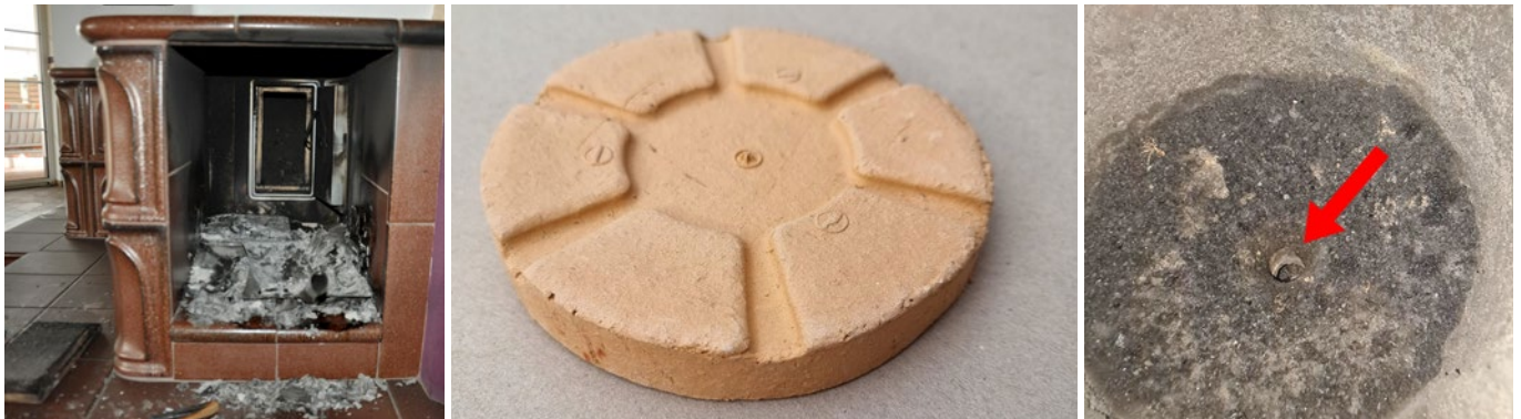
Links ist der Brandbereich im Seitenfach des Kaminofens aus dem ersten Schadenfall zu sehen. Das rechte Bild zeigt den Kondensatablauf im Sockel des Schornsteins. Ein Rußstein (mittleres Bild) hätte diesen Brandausbruch verhindert.
